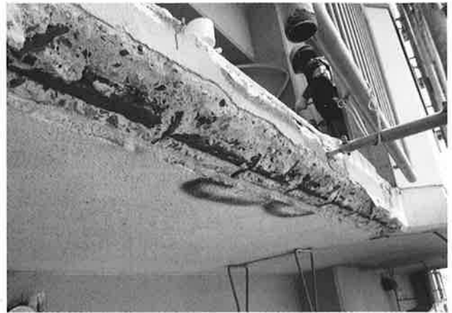
鉄筋が錆びて爆裂した状況
